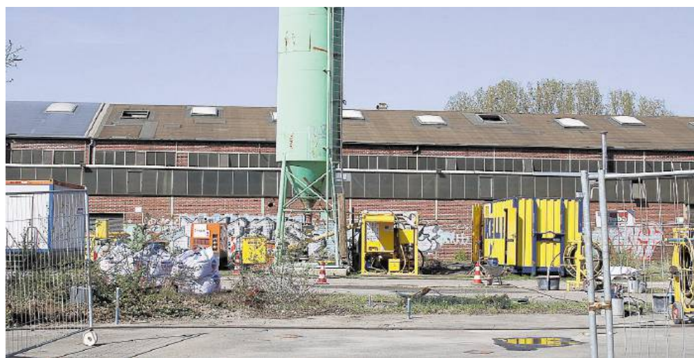
Auf dem Gelände am Krückenweg finden aktuell Bohr- und Verfüllarbeiten zur Sicherung statt.
